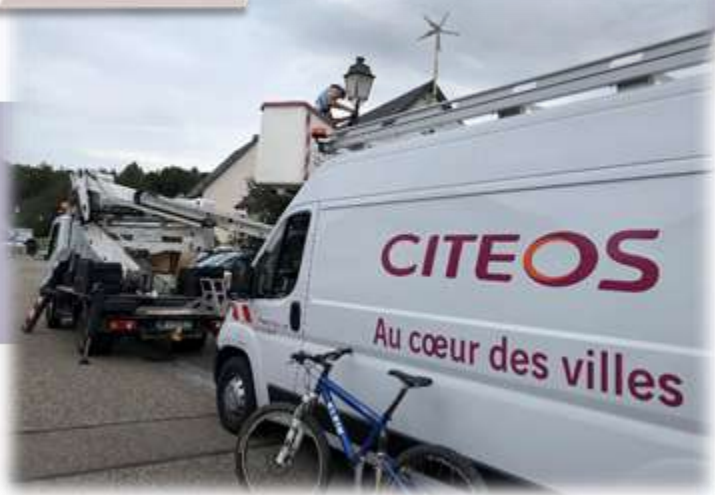
Nouvel éclairage public
